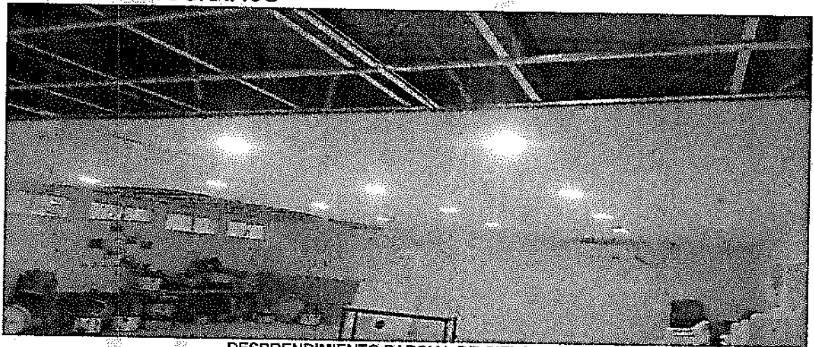
DESPRENDIMIENTO PARCIAL DE CIELO RASO
